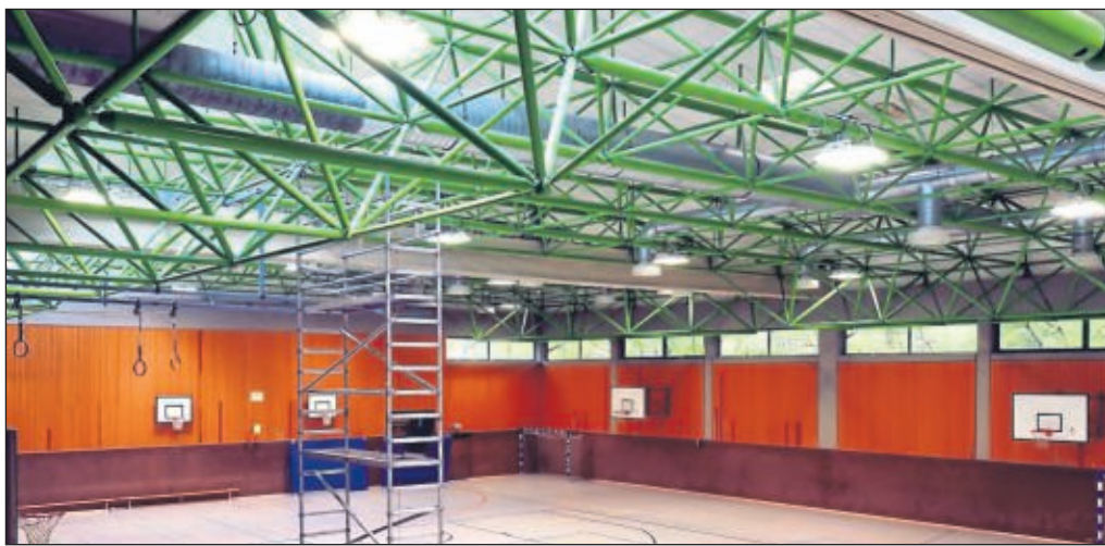
Im vergangenen Jahr wurde in der Turnhalle Köstersberg die gesamte Beleuchtungsanlage ausgetauscht – selbstverständlich durch energiesparende Leuchtmittel. ■ Archivfoto: Heyn
