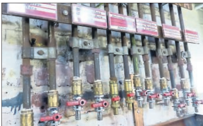
Manche Heizungstechnik ist schon reichlich in die Jahre gekommen. Ausfälle und Defekte häufen sich. ■ Archivfoto: Heyn
