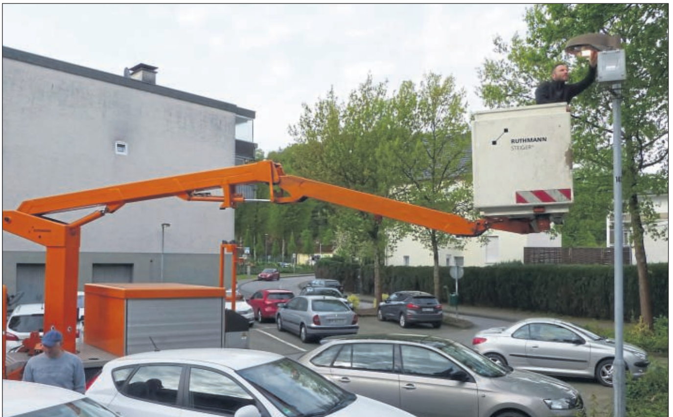
Auch im Alten Dorf haben die Mitarbeiter des Werdohler Bauhofes, hier Luciano Amico, die Laternen mit LED-Technik ausgerüstet. In vielen Werdohler Wohngebieten sind aber Energiesparlampen im Einsatz. ■ Fotos: Witt
